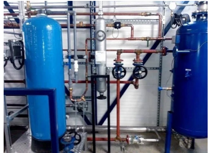
Boyer, sıcak su depolama sistemi
