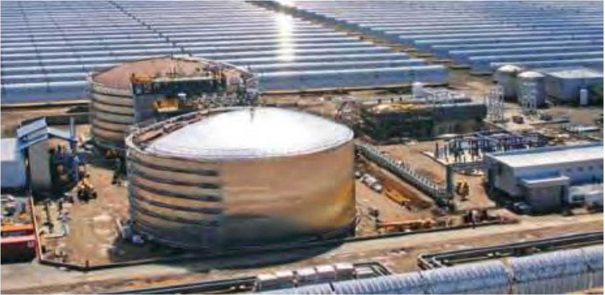
Andasol CSP tesisinde parabolic panellerden elde edilen gücün depolandığı iki ısı deposu
